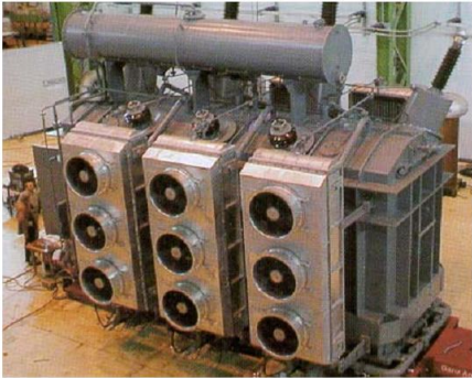
Gambar 1. Susunan Kipas Blower untuk Alat Pendingin Minyak Transformator secara udara dipaksakan
